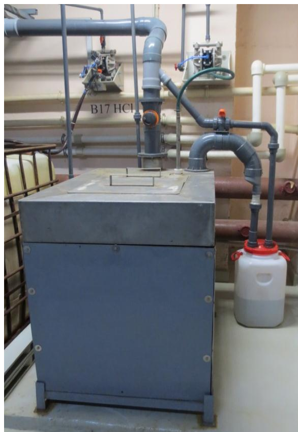
Рис. 5. Общий вид реактора и абсорбера для предварительной очистки отработанных растворов
