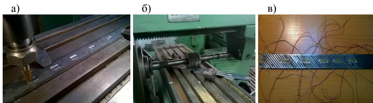
а) фрезерование пазов под тензодатчики; б) фрезерование пазов для увеличения адгезии пластины с клеевой композицией; в) монтаж тензодатчиков
