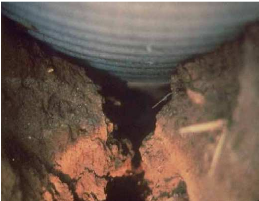
Рисунок 1.10 – Вымывание грунта из грунтового конверта, окружающего МГК
