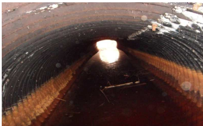
Рисунок 2.2 – Прогиб железнодорожной трубы
