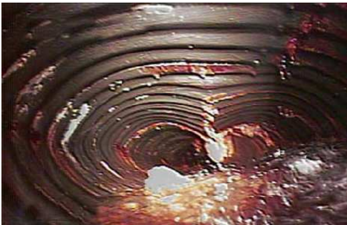
Рисунок 1.7 – Значительные деформации и разрушение МГК
