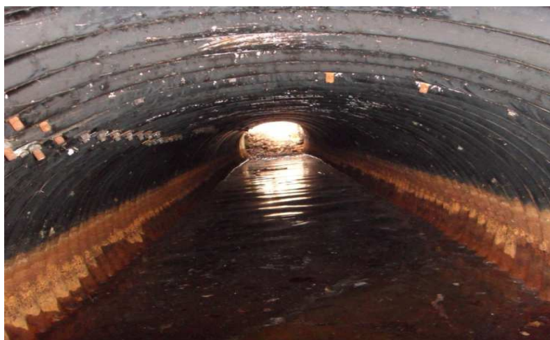
Рисунок 2.3 – Овализация тела автодорожной трубы
