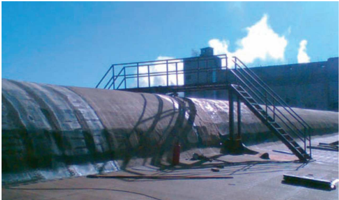
Рисунок 1.5 – Вентиляционный канал из гофрированных листов
