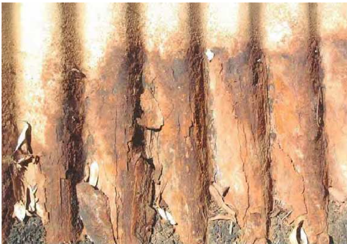
Рисунок 5.3 – Характерные коррозионные повреждения лотка МГК
