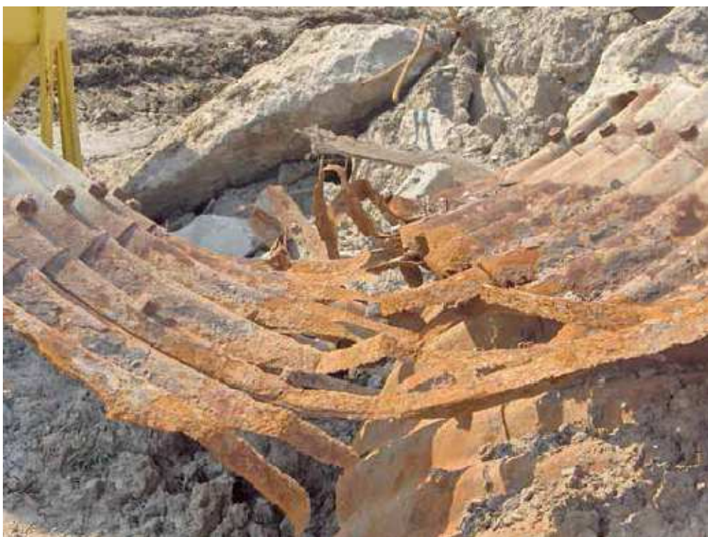
Рисунок 1.9 – Сквозная коррозия МГК
