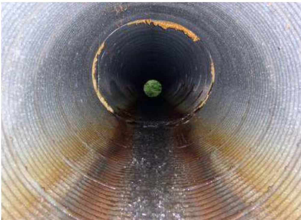
Рисунок 1.8 – Коррозионные повреждения МГК
