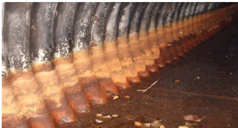
Рисунок 2.4 – Нарушение обмазочной гидроизоляции и коррозия гофрированной трубы
