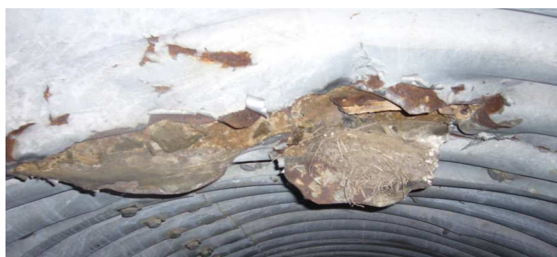
Рисунок 2.5 – Местный разрыв стенки гофрированной трубы
