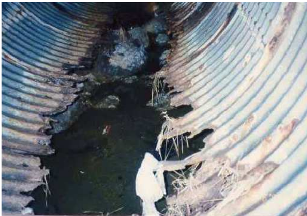
Рисунок 1.11 –Сквозные повреждения лотковой части МГК вследствие абразивного износа
