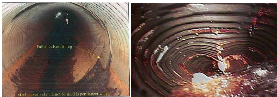
Рисунок 8 – Значительные деформации и разрушение МГК со следами коррозионных повреждений
