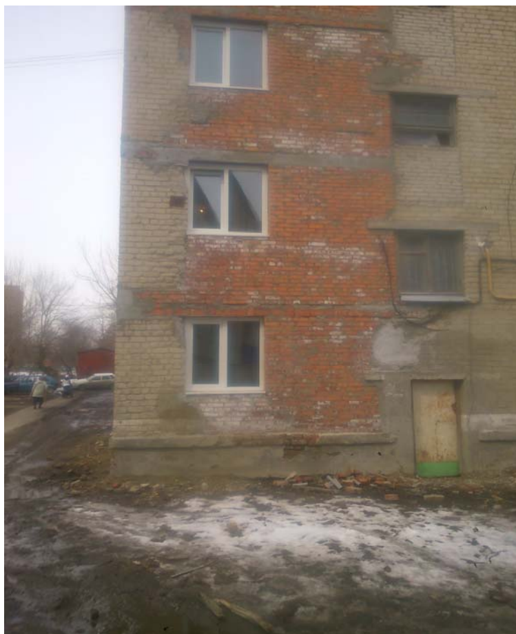
Рис.2.5. Разрушение кирпичной кладки вследствие промерзания увлажненного слоя
