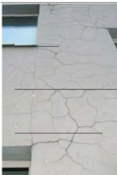
Рисунок 1.5 – Трещины на штукатурке, затворенной избытком воды [Привод. по: 37]
